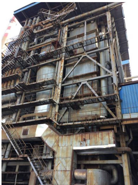
锅炉低氮燃烧设备
